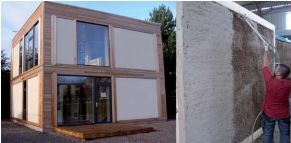
Bale, Universidad de Bath, Gales. Prototipo habitacional construido con paneles prefabricados de madera rellenos con fardos de paja. Fuente: Walker 2013.
